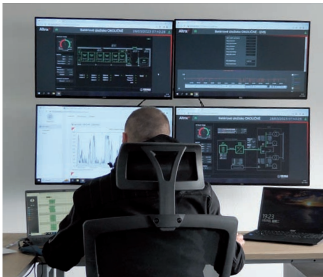
Z dispečerského pracoviska dokážu technici TESLA LH monitorovať činnosť batériových úložísk dodaných zákazníkom v Nemecku, Holandsku či vo Švédsku
