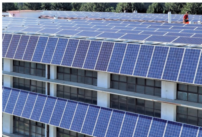
Na strechách a bočných fasádach budov bolo osadených celkovo 1 514 fotovoltických (FV) panelov.
